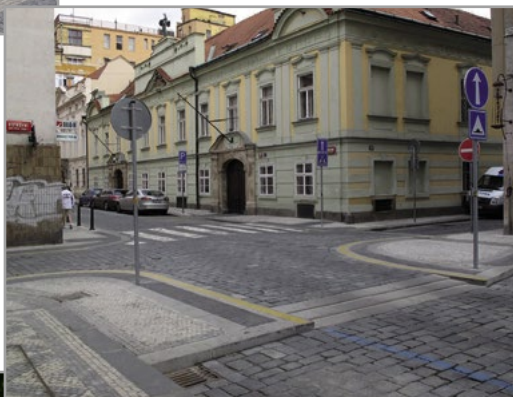
Stavební úpravy křižovatky Ostrovní x Voršilská – rozšíření nároží, zkrácení přechodů, zvednutí plochy křižovatky (ZŠ sv. Vršily projekt v r. 2007, realizace 2012)
